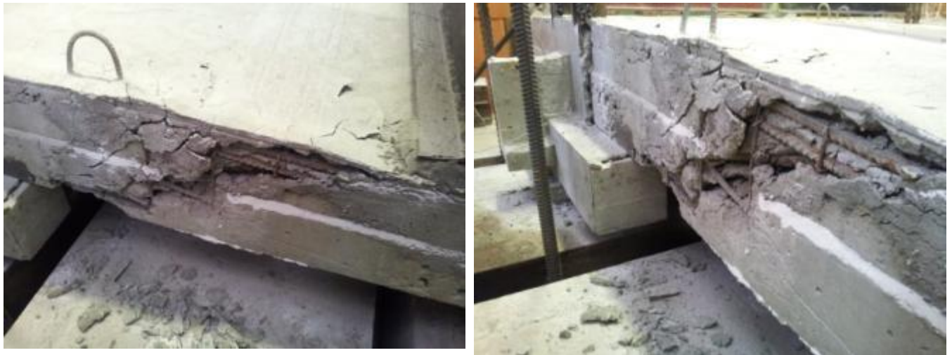
Рисунок 3.33 – Образование наклонных трещин и разрушение продольного ребра плиты
